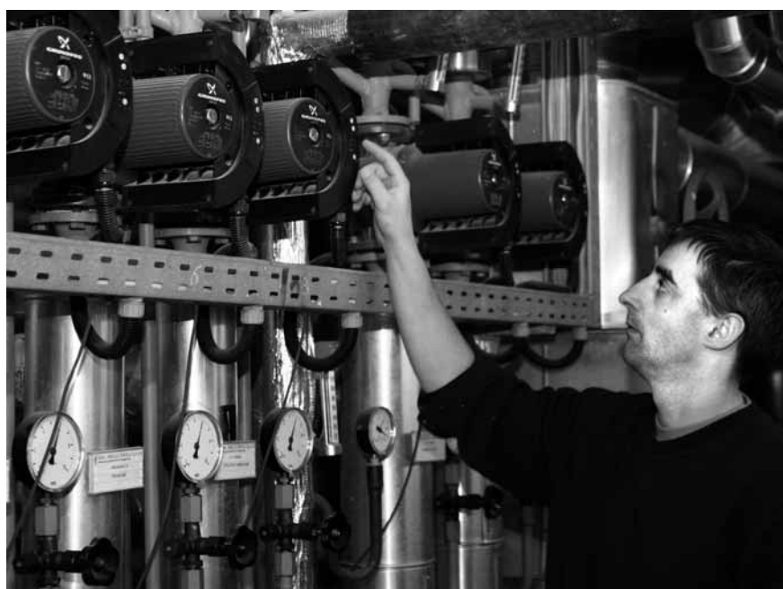
Hautechniker Fred Smolinski in der Heizzentrale 1 des Schlosses. Davon gibt es insgesamt sechs, die die ca. 2500 Heizkörper im Schloss mit Wärme versorgen.
