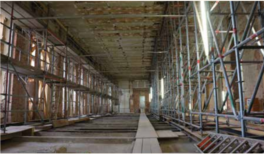
Die Decke des alten Plenarsaals im 3. Obergeschoss des Burgseeflügels muss komplett erneuert werden. Die Fraktionsräume im 4. Obergeschoss können während der Baumaßnahme nicht genutzt werden.
