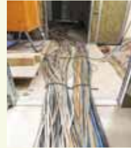
Im 4. Obergeschoss werden im Boden sämtliche Kabel "versteckt".
