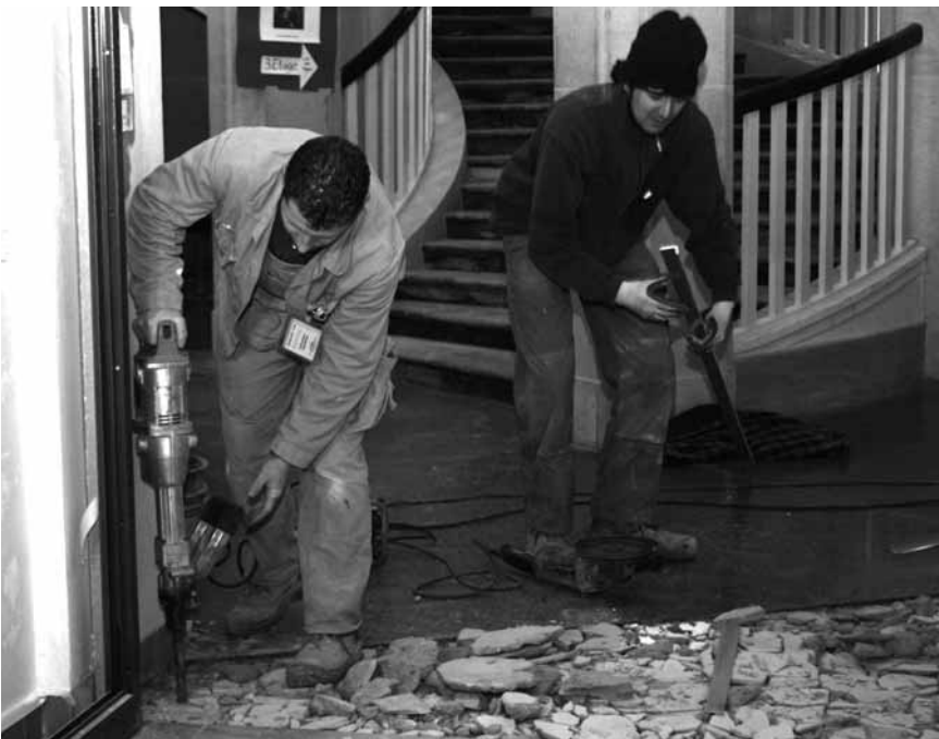
Noch wird gebaut: Mario Seidler (li.) und Marco Antonioli von der Firma Peter Antonioli aus Steegen bei Fußbodenarbeiten.
