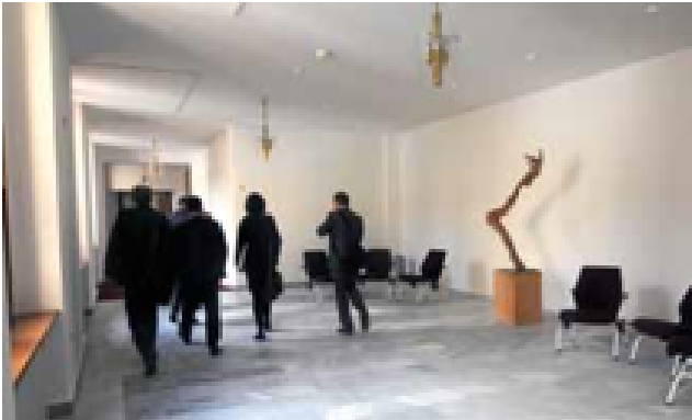
Blick in die neue Lobby. Im Zuge der Abbrucharbeiten wurden auch die bisherigen Stützpfeiler entfernt.
