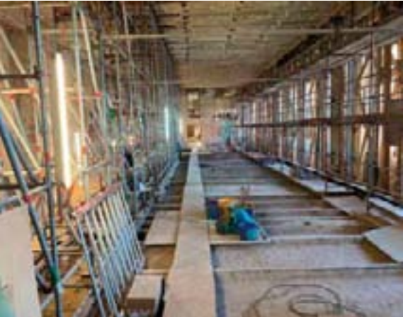
Der ehemalige Plenarsaal im 3. OG mit Blick Richtung ehemaligem Presse- und Besucherbereich.
