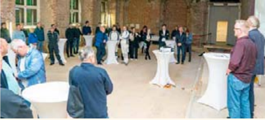
Mit der fertiggestellten Decke zwischen dritter und vierter Etage sind die Arbeiten am Rohbau abgeschlossen. Das haben Landtagspräsidentin Birgit Hesse, Landtagsdirektor Armin Tebben und Mitglieder der Baukommission gemeinsam mit den verschiedenen Gewerken bei einem kleinen Imbiss gefeiert.
