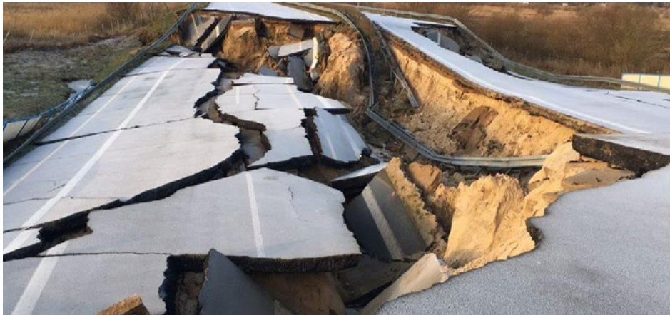
Der Petent kritisierte das Vorgehen der Landesregierung bei der Instandsetzung der abgesackten Autobahn bei Tribsees. Foto: Energieministerium M-V 2018
