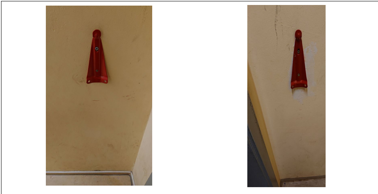
Abbildung 23: Beispiele für fehlende Feuerlöscher
